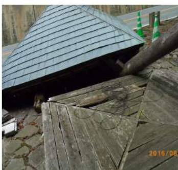
倒壊した公衆便所
