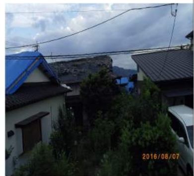
屋根瓦が崩れた民家
